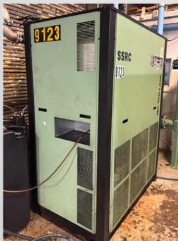
SULLAIR SSRC-1000-A AIR DRYER
