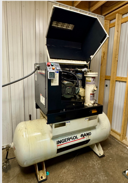
INGERSOLL RAND SSR-EP15 15HP AIR COMPRESSOR
